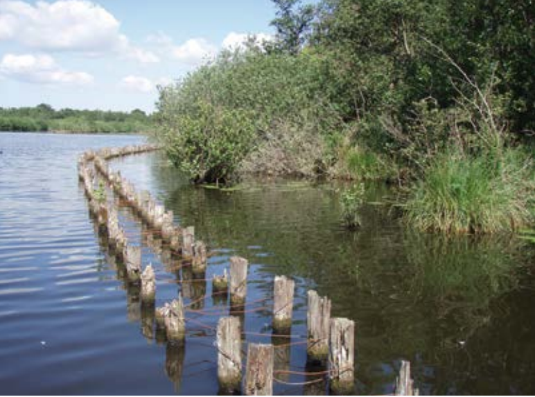
De oever van het Hilversums Kanaal is totaal vervallen.
